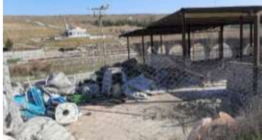
Şekil 20 Dicle Köprüsünde Çevresel Bozulma (İler, 2022)
